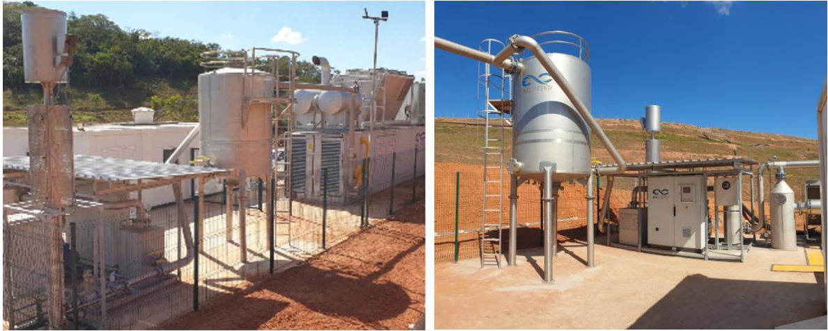
Figura 7 – Usina de Biogás no aterro sanitário Conselheiro Josino
