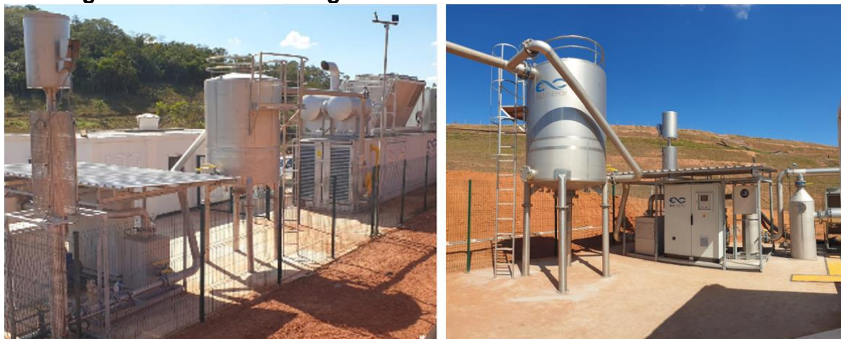
Figura 13 – Usina de Biogás no aterro sanitário Conselheiro Josino
